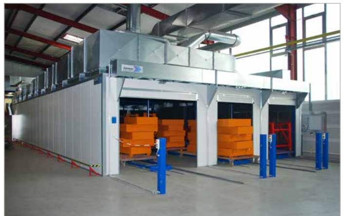
Lackiererei mit Trocknungsstraße
